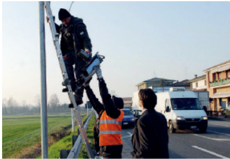
INSTALLAZIONE Un impianto T red montato a un semaforo
